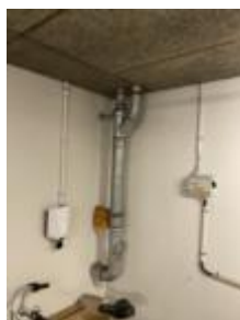
Afløb i kælder
