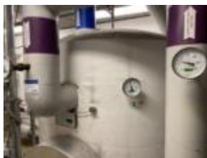
Varmtvandsbeholder i varmecentral
