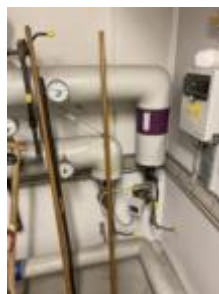
Styring til pumpebrønd
